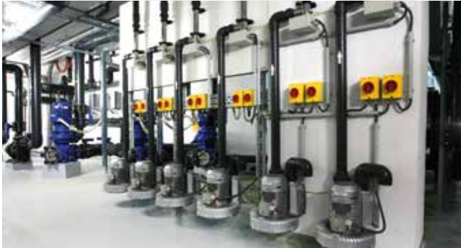
Dmýchadla vzduchové masáže v aquaparku v Domažlicích Blowers for air massages in the waterpark in Domažlice, the Czech Republic
