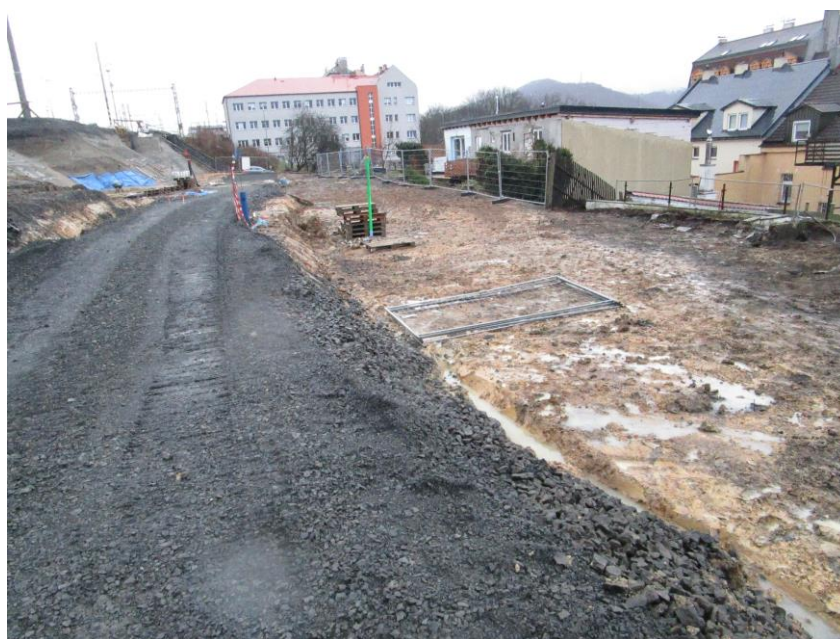
6 Sesuv tratě v KV - velmi nepříznivé až nevhodné jsou zeminy podloží násypu
