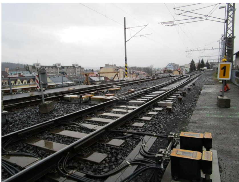
2 Sesuv tratě v KV - pohled směrem na Cheb
