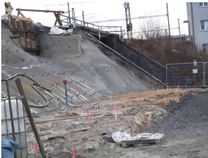
9 Sesuv tratě v KV - sanace násypu začíná u silničního podjezdu ulice Jáchymovská
