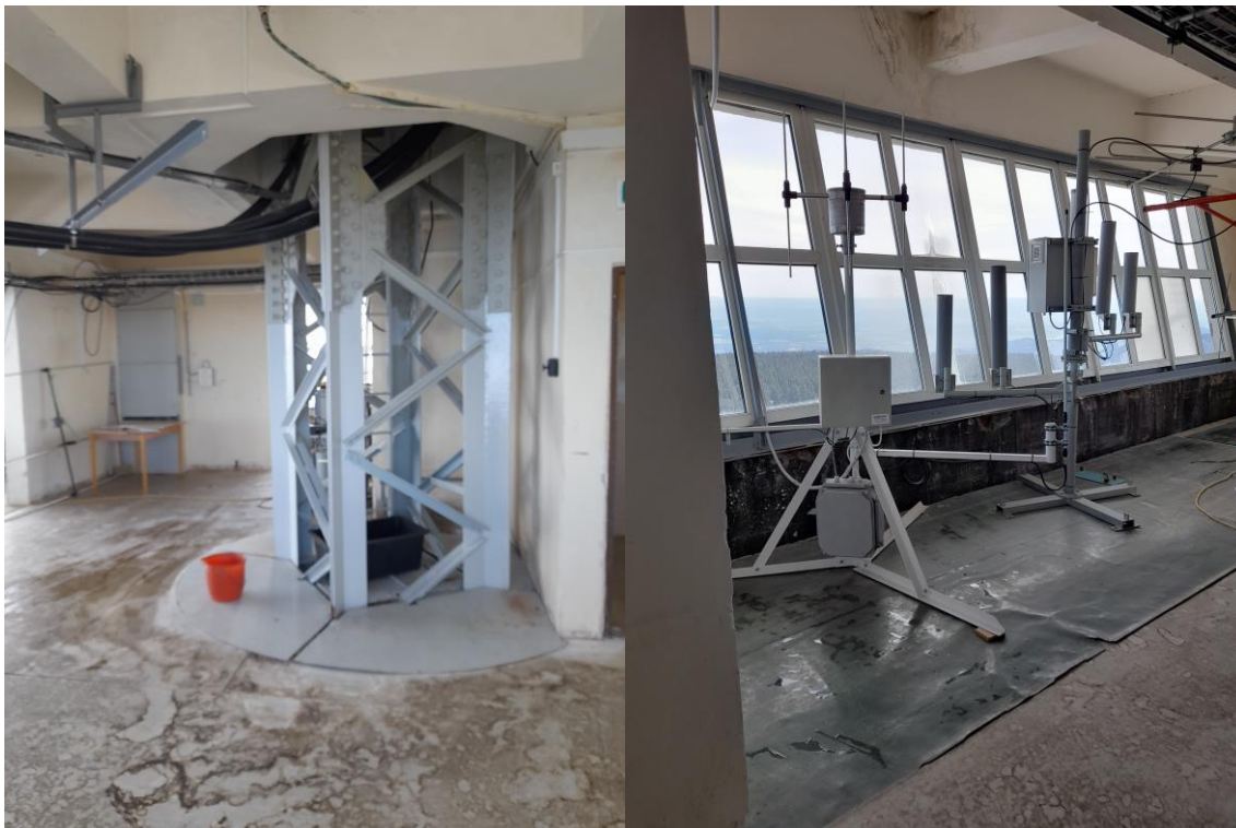
Technologické podlaží na vrcholu věže je osazeno spojovací technikou různých společností
